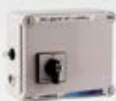
97-99 ΗΛΕΚΤΡ. ΠΙΝΑΚΕΣ & ΠΑΡΕΛΚΟΜΕΝΑ ΑΝΤΛΙΩΝ
